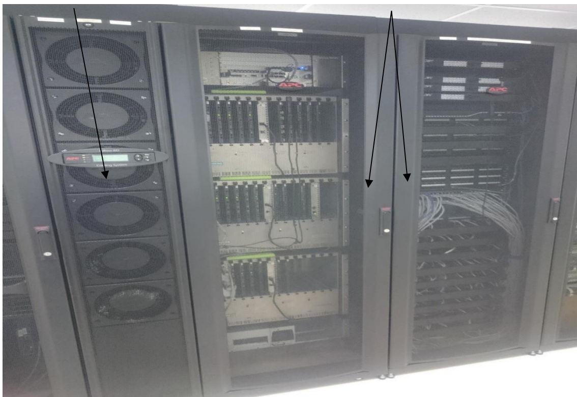
11.1.1.3. Sala de Infraestrutura Física de TI da SEFAZ/ES – Corredor de Ar Quente (SALA 1)
