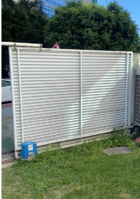
Portão Automático Área Carga e Descarga – Parte Interna
