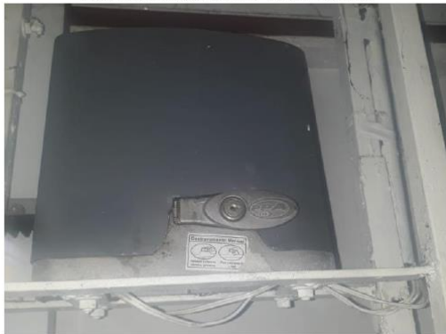
Motor do Portão Automático com Proteção
