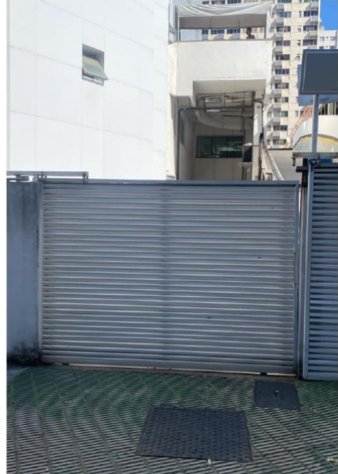
Portão Automático Área Carga e Descarga – Parte Externa
