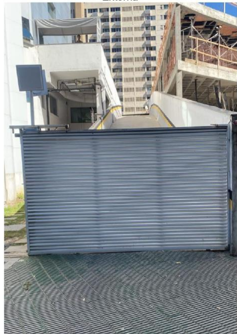
Portão Automático Acesso ao Estacionamento – Parte Externa
