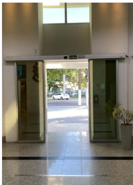
Porta Automática – Parte Interna
