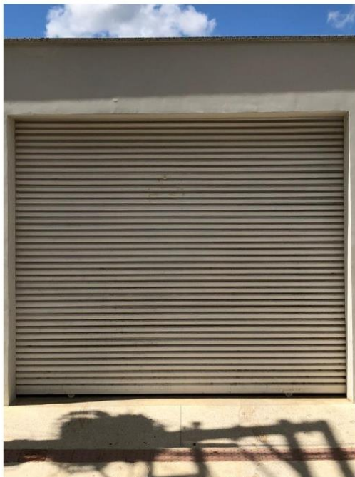
Portão Automático – Parte Externa
