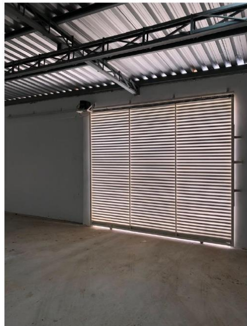
Portão Automático – Parte Interna
