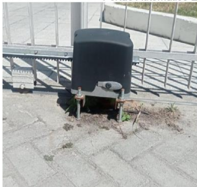
Motor do Portão Automático do Estacionamento 01
