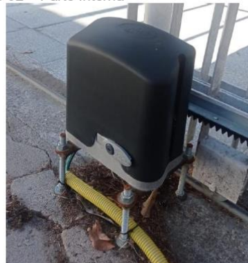
Motor do Portão Automático do Estacionamento 02
