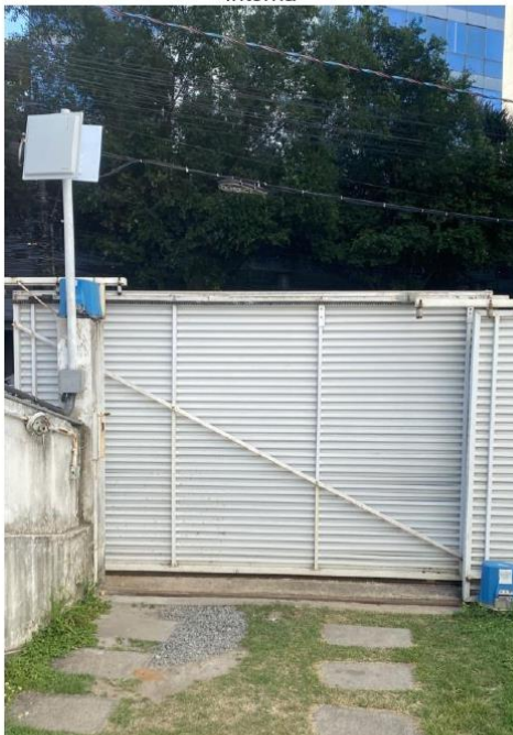
Portão Automático Acesso ao Estacionamento – Parte Interna
